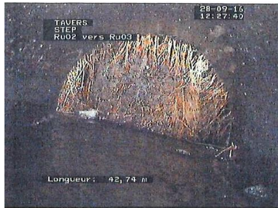
Figure 44 : Extrait de l'inspection caméra sur la conduite de rejet des eaux épurées
